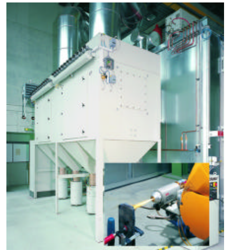
6: Entstaubungsanlage mit geregelter Absaugleistung – Flammstritzen
