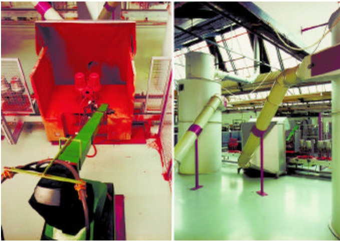
7: Entstaubungsanlage für die Nasslack-Oversprayabsaugung
